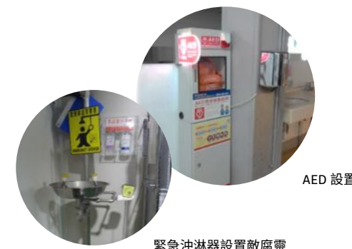
緊急沖淋器設置敵腐靈
